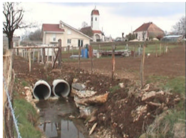
Arrivée du réseau d'eaux pluviales vers la station d'épuration.
